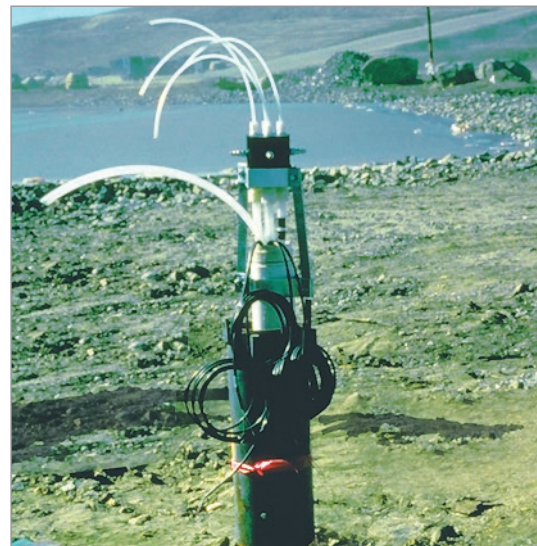
Sitio de vertedero sobre granito fracturado, monitorizado con cinco sistemas Waterloo. Cada sistema compuesto por bombas de doble válvula dedicadas y transductores de presión en intervalos de 4-6 a profundidades de 275 pies (84 m). El manifold de purgas múltiples permitió la monitorización de 21 zonas que se completó en menos de 2 días.
