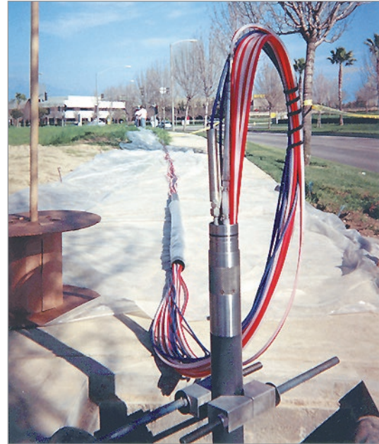
Investigación de contaminantes en una base aérea de EE. UU. Sistemas Waterloo instalados a 700 pies en sobrecarga usando pozos con filtro y encamisados. Hasta 6 zonas por orificio con bombas y transductores dedicados.
